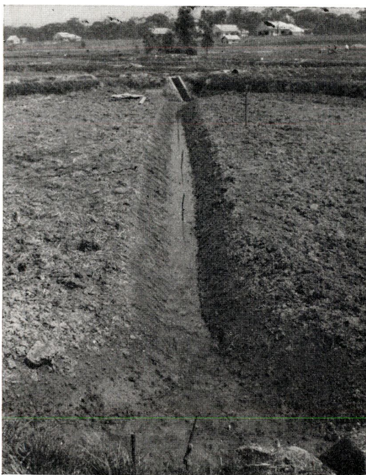
Fig. 30 — L'aménagement des refuges : vue d'amont, le refuge au pied de la prise d'eau et la tranchée joignant la prise d'eau à la digue percée.
